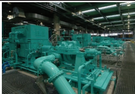
高圧ROポンプ設備
