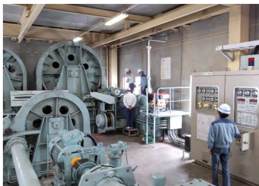
ゲートの管理運転の様子
