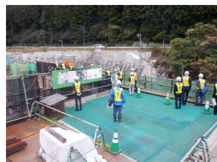
大芦川取水放流工
