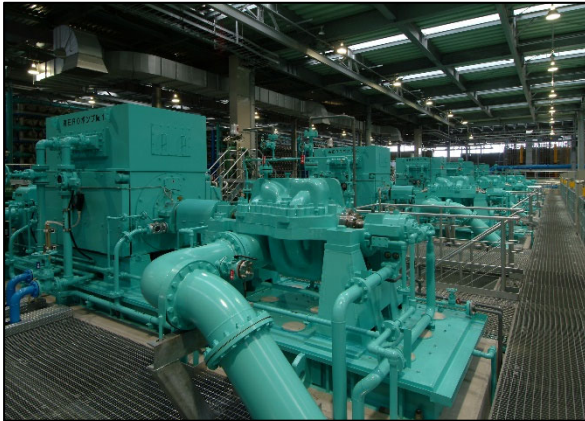
海水淡水化センター 高圧ROポンプ設備
