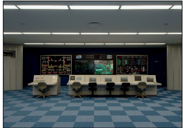
海水淡水化センター 中央監視設備
