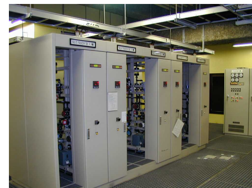
苛性ソーダ注入設備
