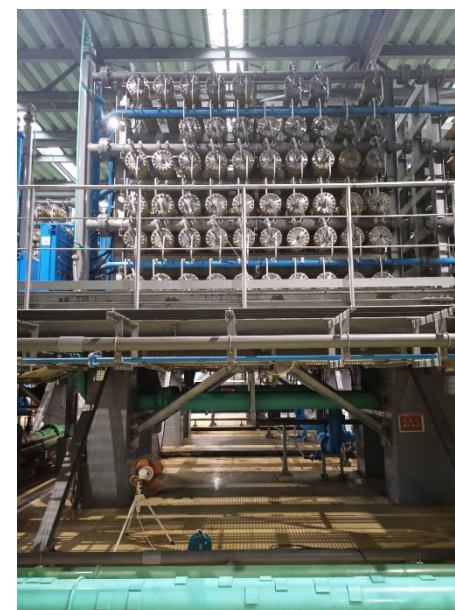
高圧RO膜設備
