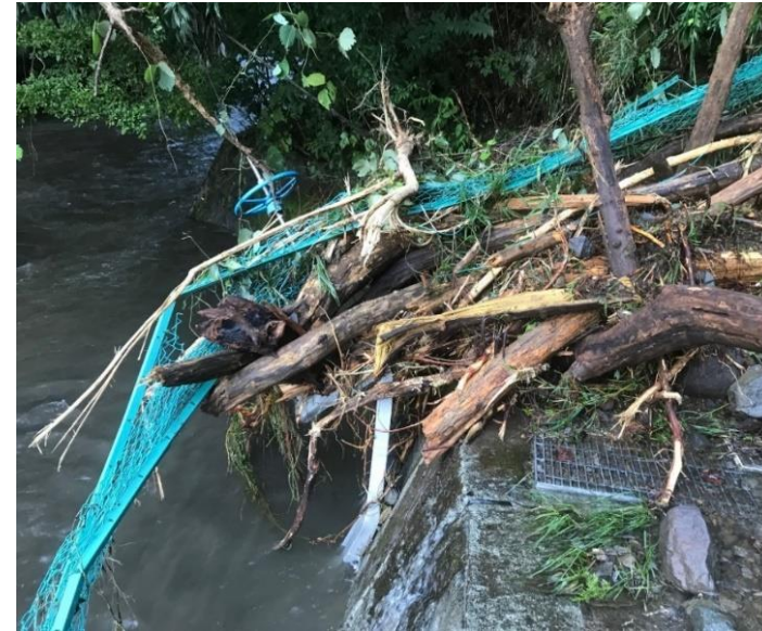
令和元年台風第19号による取水門の被災状況 (神奈川県南足柄市(約6,900戸断水))
